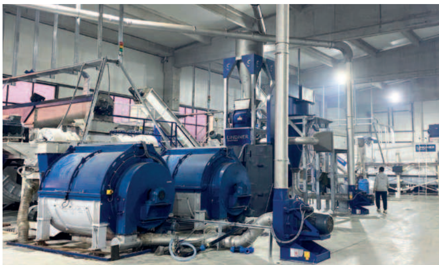
Die von Lindner Washtech gelieferte Waschlinie bildet den Recyclingprozess bei Plastika Kosovo durchgängig ab – von der Zerkleinerung über Wasch- und Trocknungsschritte bis zur Extrusion (Bilder Copyright © Lindner)
